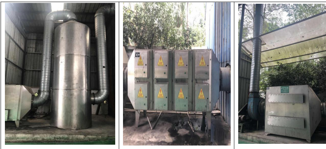
水喷淋洗涤塔+过滤脱水+低温等离子+UV 光氧+活性炭吸附装置及排气筒
