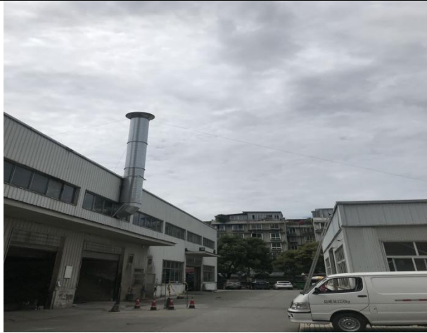
漆雾过滤棉+UV 光氧催化+两级活性炭吸附装置及排气筒
