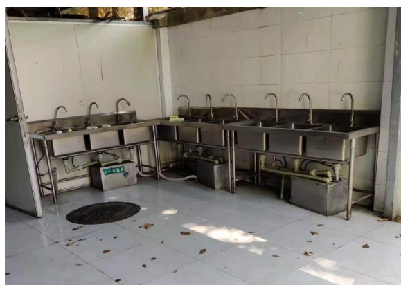
餐饮废水隔油池
