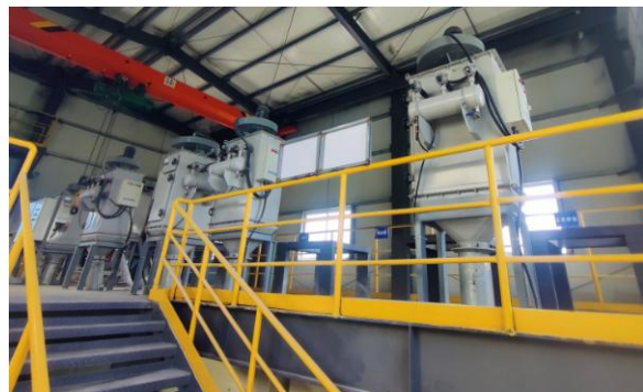
配料处除尘器（6台）
