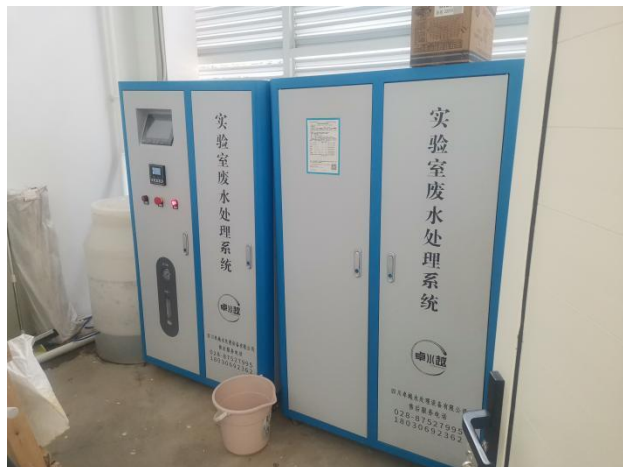
污水处理设施
