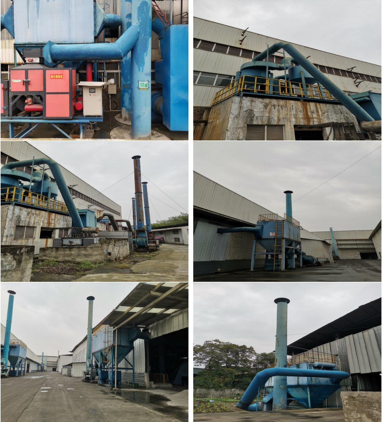
废气治理设施及废气排口
